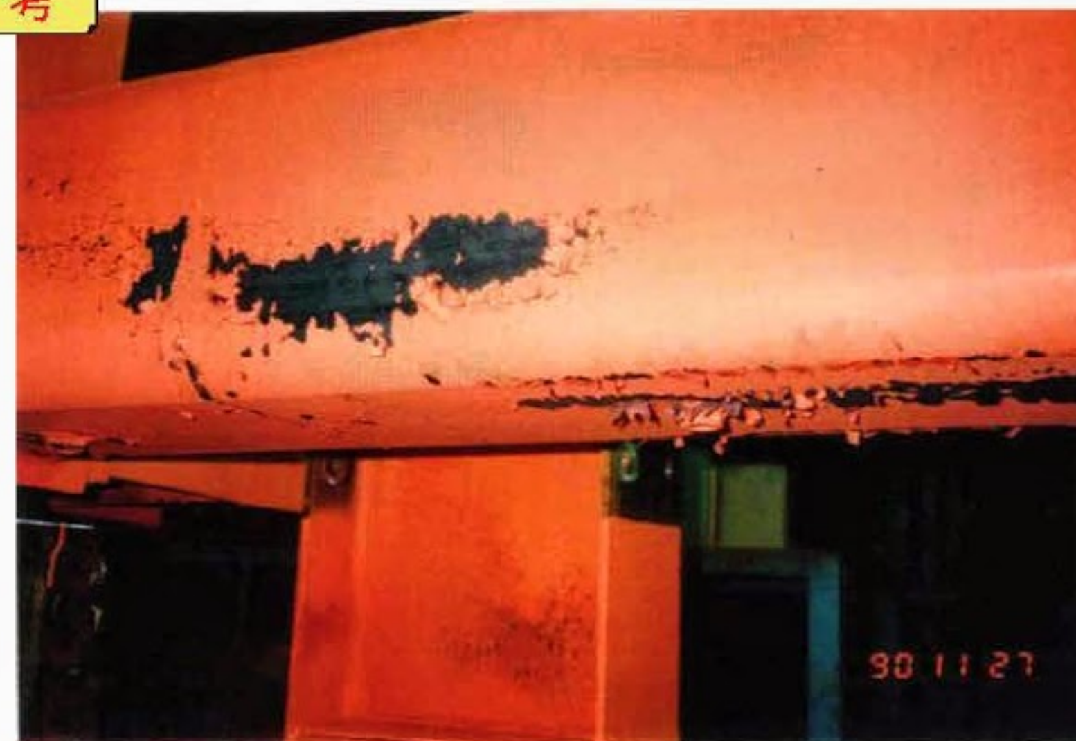
油分除去不十分の場合の塗膜剥離事例
