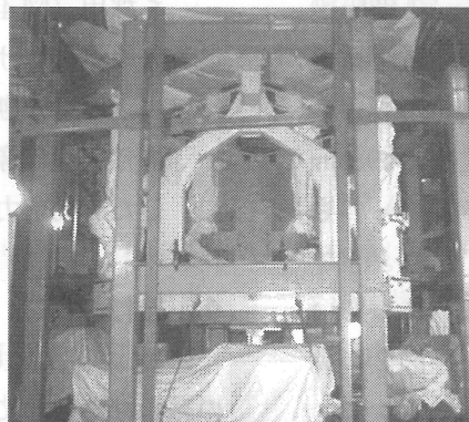
ホテル棟制振装置
