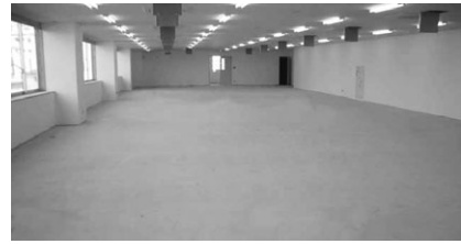
「コンクリート膨張材」を使ったデッキスラブコンクリート例（ひび割れは全く確認されていない）
