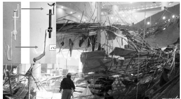
写真2 被害状況の例
